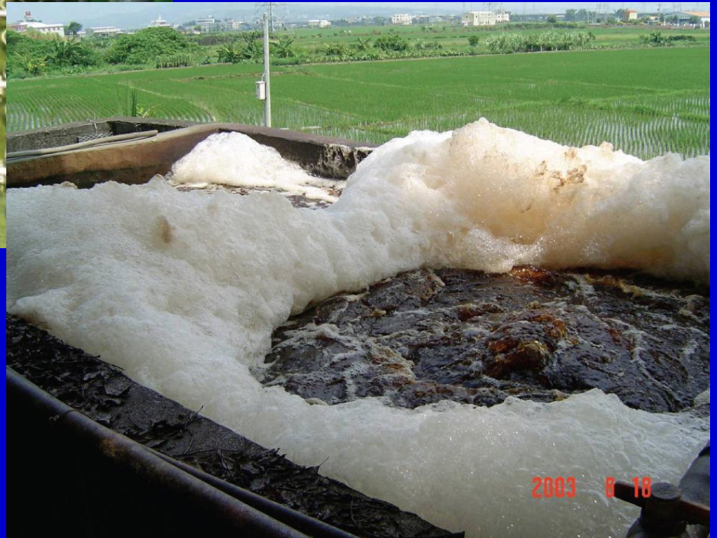
曝氣槽泡沫異常現象
